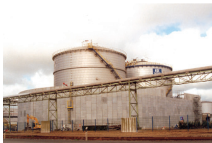
Diques de contención para depósitos de amoniaco en Montoir (Francia)
