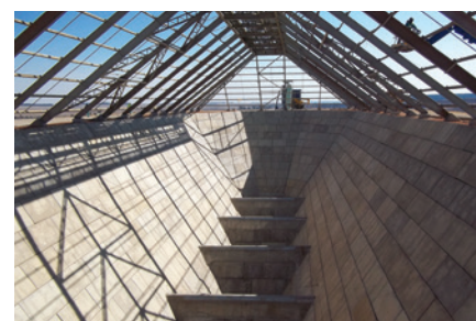
Tolva vaciable para el almacenamiento de carbón en Dorstfontein (Sudáfrica)
